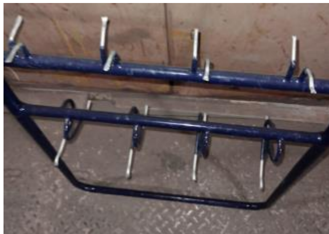
Figura 4.6 Rack sin fijadores
